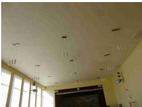
Obr.č.15 Prvky systému umelého osvetlenia
