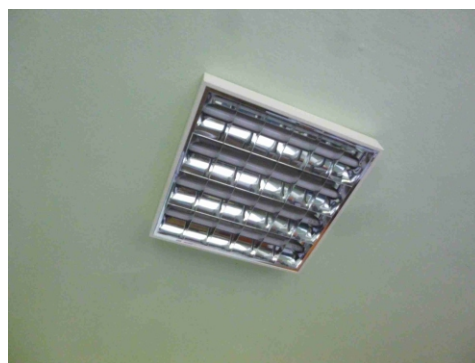
Obr.č.16 Prvky systému umelého osvetlenia
