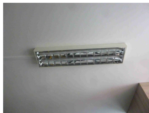
Obr.č.16 Prvky systému umelého osvetlenia
