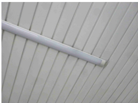
Obr.č.15 Prvky systému umelého osvetlenia
