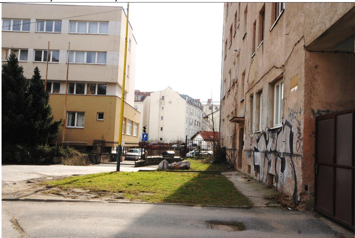
Pohľad na vstup, viď. vyššie, v úrovni parteru obytného domu (Kasárenské nám. č. 2). Narušená fasáda domu a neudržiavaná zelená trávnatá plocha v mieste výjazdu áut z dvora – z prejazdu do dvora domu.
