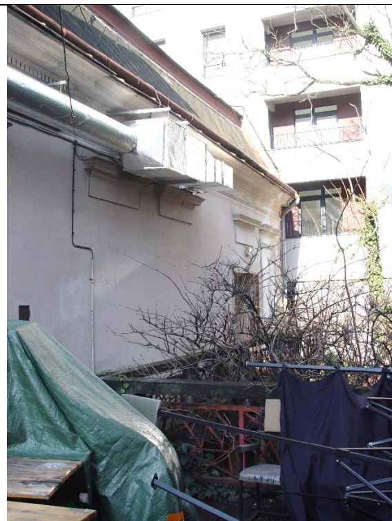
57 Pohľad na dvorovú fasádu kina s nevhodne trasovaným potrubím VZT. Celý dvor aj s terasou pôsobí výrazne zanedbane.
