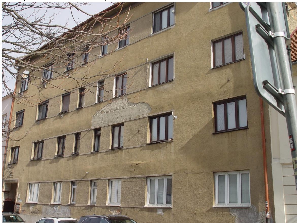
Poškodená fasáda objektu s povrchovo ťahanými káblovými rozvodmi a rôznofarebnými oknami.
