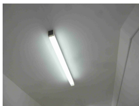
Obr.č.16 Prvky systému umelého osvetlenia
