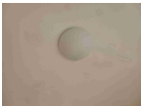
Obr.č.15 Prvky systému umelého osvetlenia
