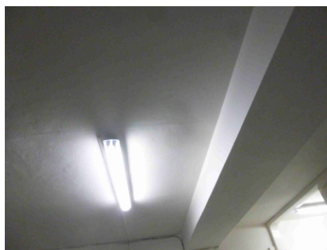
Obr.č.16 Prvky systému umelého osvetlenia
