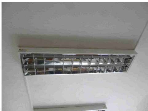
Obr.č.15 Prvky systému umelého osvetlenia
