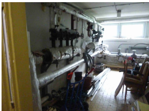
Obr.č.9 Prvky systému vykurovania
