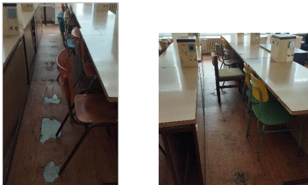
Obrázok 3 – 4 Nevyhovujúce podlahové krytiny – odborné učebne
