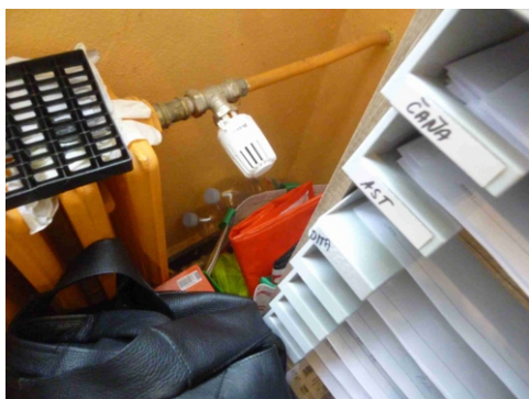
Obr.č.9 Prvky systému vykurovania
