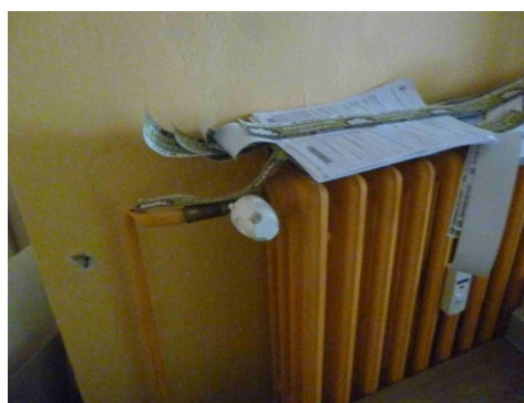
Obr.č.12 Prvky systému vykurovania
