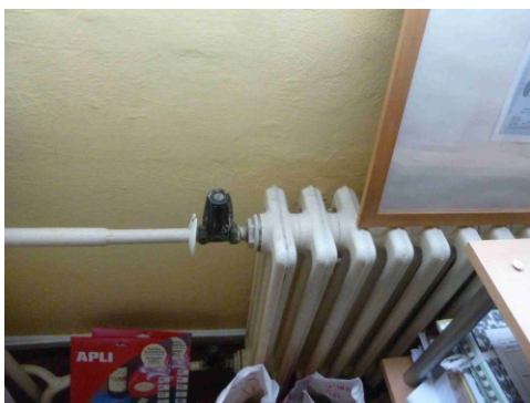
Obr.č.11 Prvky systému vykurovania
