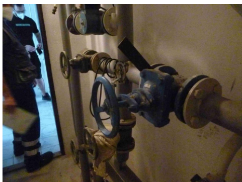
Obr.č.9 Prvky systému vykurovania
