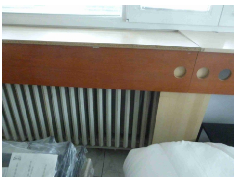
Obr.č.8 Prvky systému vykurovania
