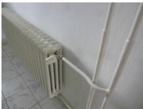
Obr.č.11 Prvky systému vykurovania
