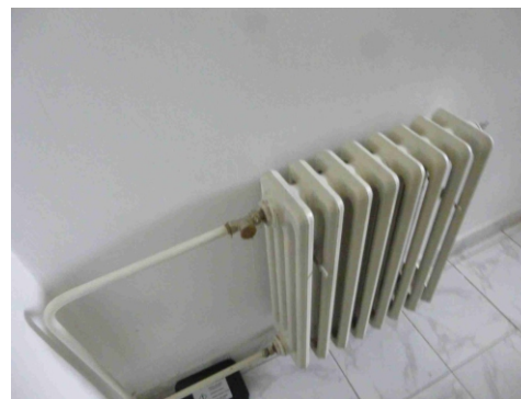
Obr.č.12 Prvky systému vykurovania
